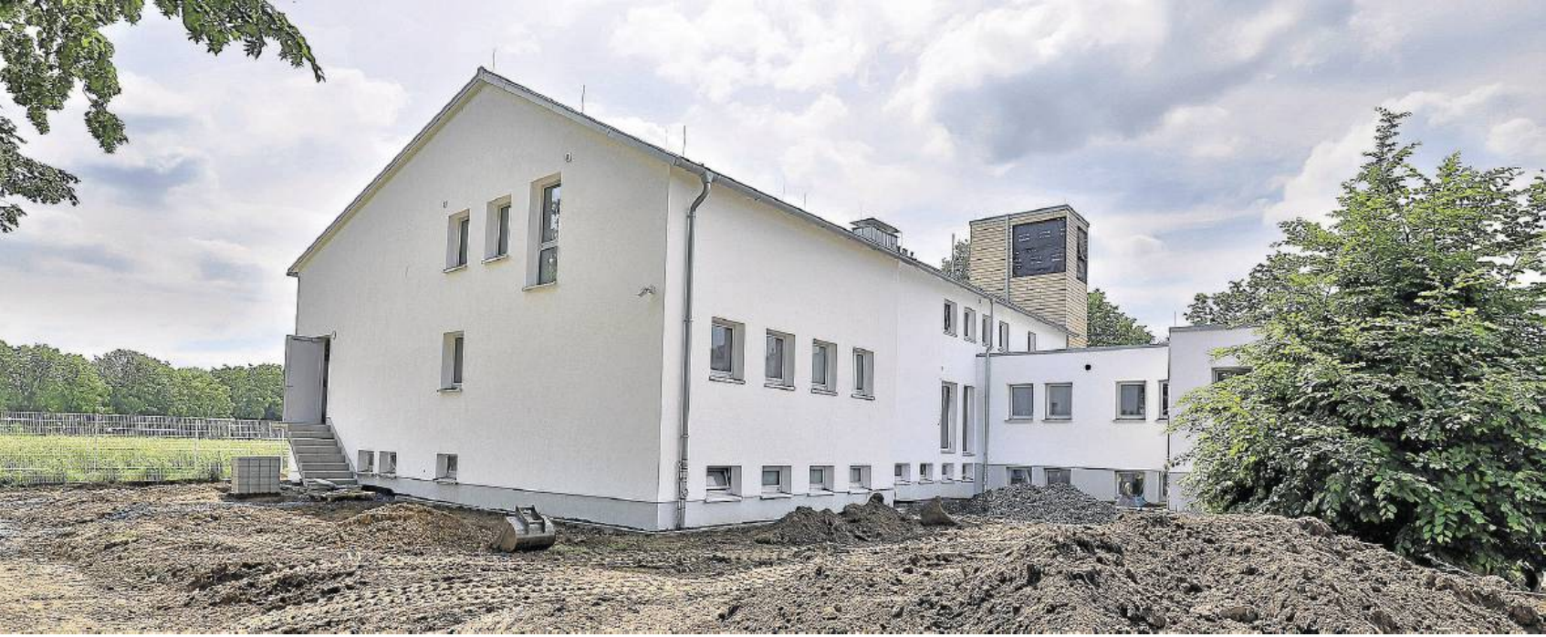
Hinter der Synagoge entsteht ein Garten. Gut zu erkennen: Der Turm des ehemaligen Bodelschwingh-Hauses wird nach allen Seiten einen Davidstern zeigen – aktuell klappt dort noch eine Lücke.
